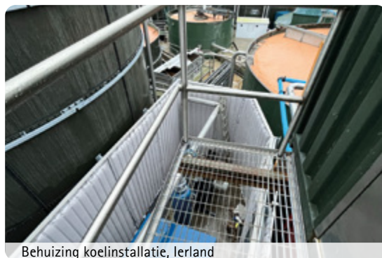
Behuizing koelinstallatie, Ierland
