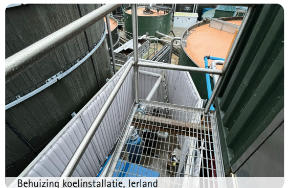
Behuizing koelinstallatie, Ierland
